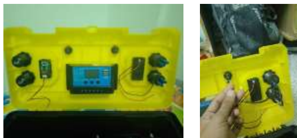
ภาพที่ 3 แสดงการต่อวงจรในกล่องกักเก็บพลังงานไฟฟ้า
