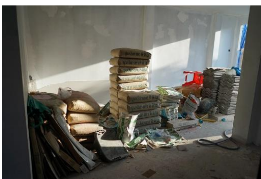
ภาพที่ 12. ที่จัดเก็บปูนก่อนฉาบ
